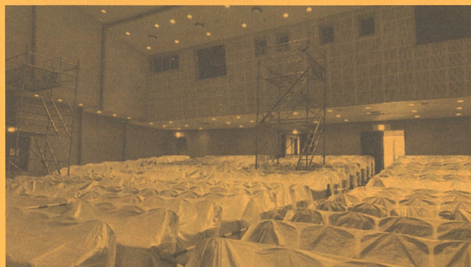
【小ホール】大ホールと同様に様々な機器を更新。客席はビニールシートで全面養生されています。
